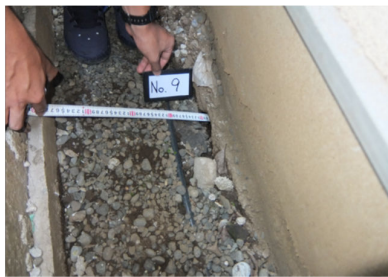
沈下状況写真
